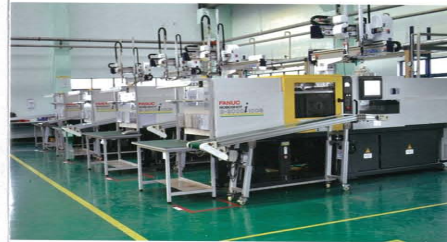
成型工場(第3工場) Molding Plant(No.3 Plant) 사출공장
